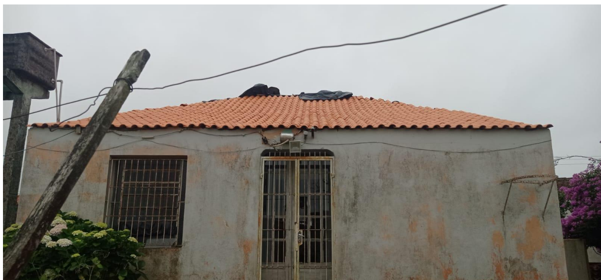
Telhas que devem ser realinhadas
